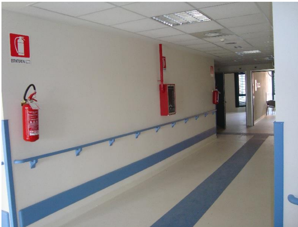
Рисунок 11 – Пример оборудования палатного отделения первичными средствами пожаротушения
