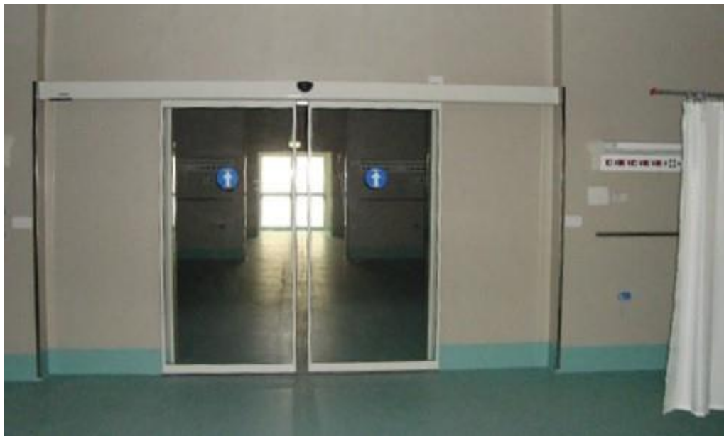
Рисунок 17 – Пример установки раздвижных дверей при входе в оперблок
